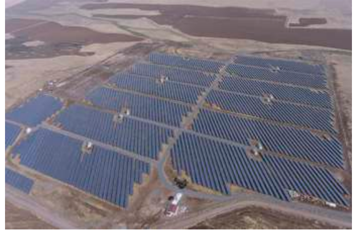
ŞANLIURFA / SİVEREK / YOĞUNCA 15.444 kWp
